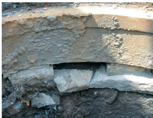
Zničená maltová spára
