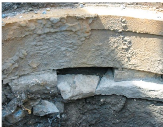
Zničená maltová spára
