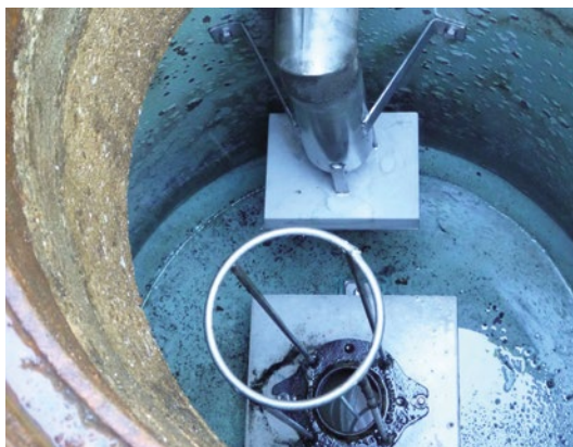
Toto poškození je nyní minulostí: Poškozený ochranný nátěr
