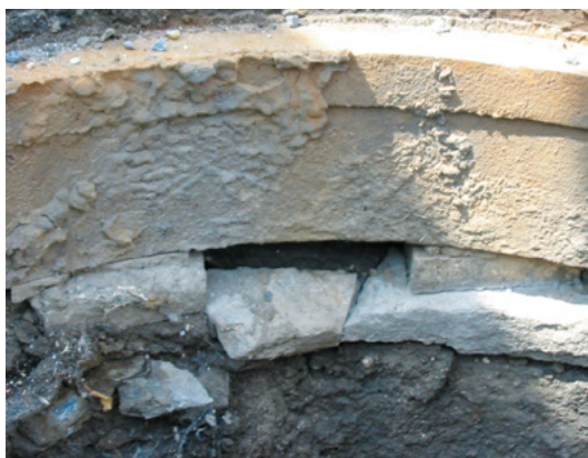
Zničená maltová spára
