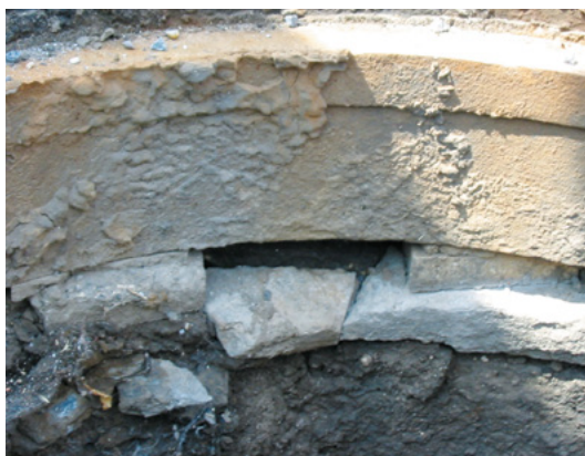
Zničená maltová spára
